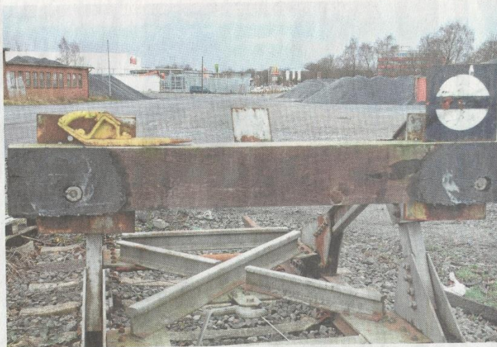
Dieses tote Gleis unter der Max-Johannes-Brücke in Neumünster wird deutlich verlängert – fast bis zu McDonalds an der Brückenstraße (im Hintergrund). Auf der erweiterten Fläche sollen Lkw zur Verladung von Containern direkt an die Züge heranfahren.
