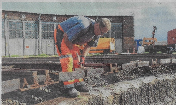
Raimund Gemser beseitigt am Betonring der Drehscheibe mit dem Bohrhämmer loses Material.
